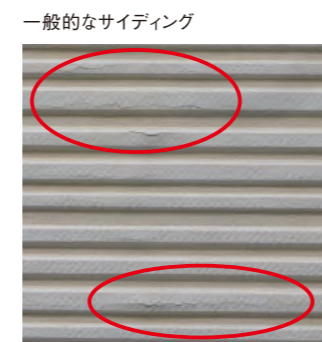
100サイクル未満 亀裂発生
