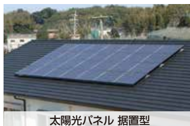
太陽光パネル 据置型
