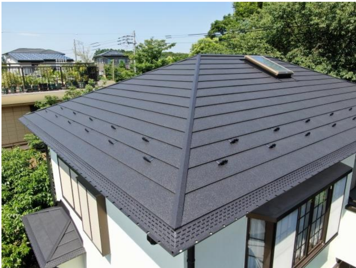
元旦内樋（住宅用）、断熱ビューティルーフ2型（住宅用横葺き金属屋根）施工物件
