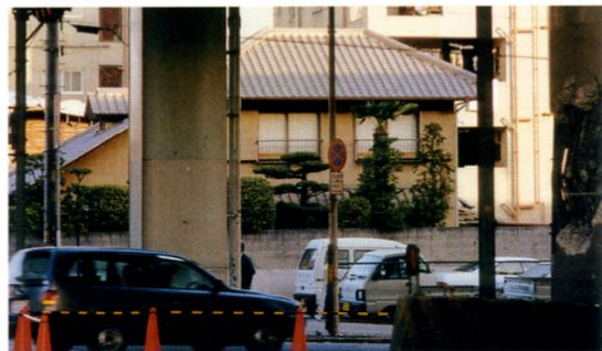
崩壊した阪神高速付近の瓦屋根木造住宅 ※出典：阪神淡路大震災の教訓 平成7年4月(株)日本屋根経済新聞社
